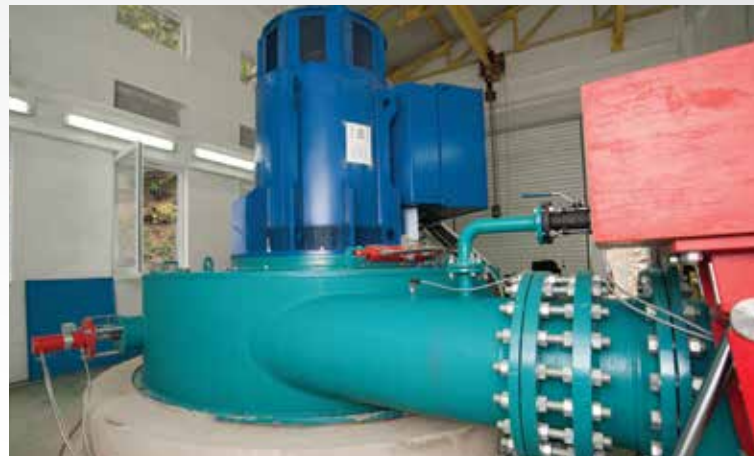
Turbine u maloj hidroelektrani
